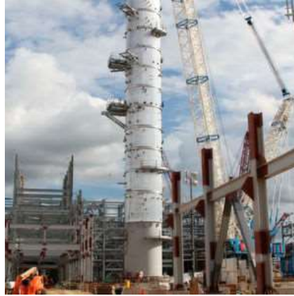
Şekil 1. Gaz Arama İstasyonu
