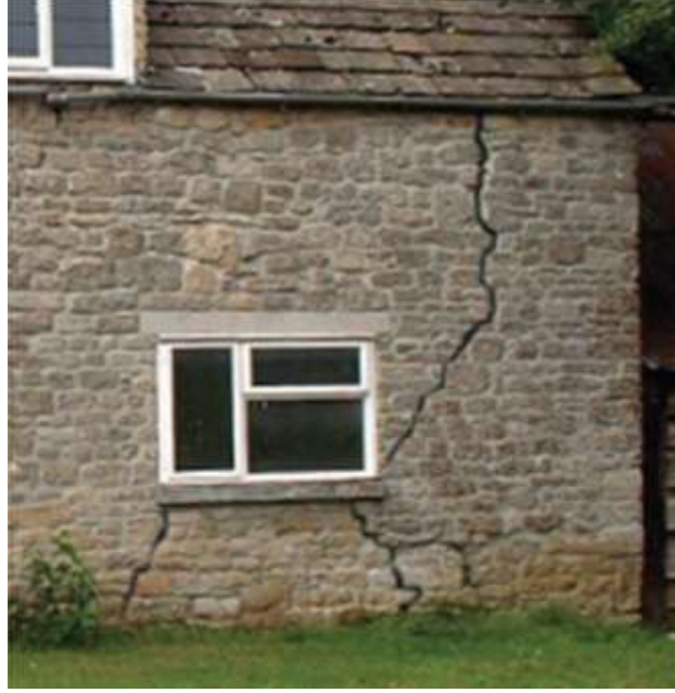
Şekil 2. Oturma Çatlağı (URL-1)
